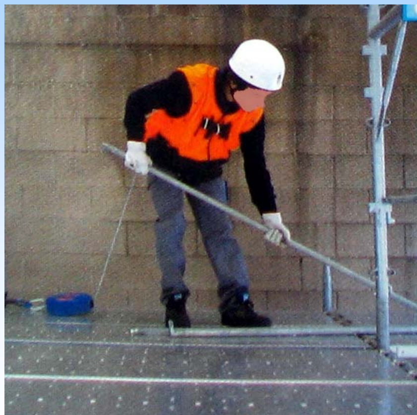
L'OPERATORE PUO' LAVORARE IN SICUREZZA
