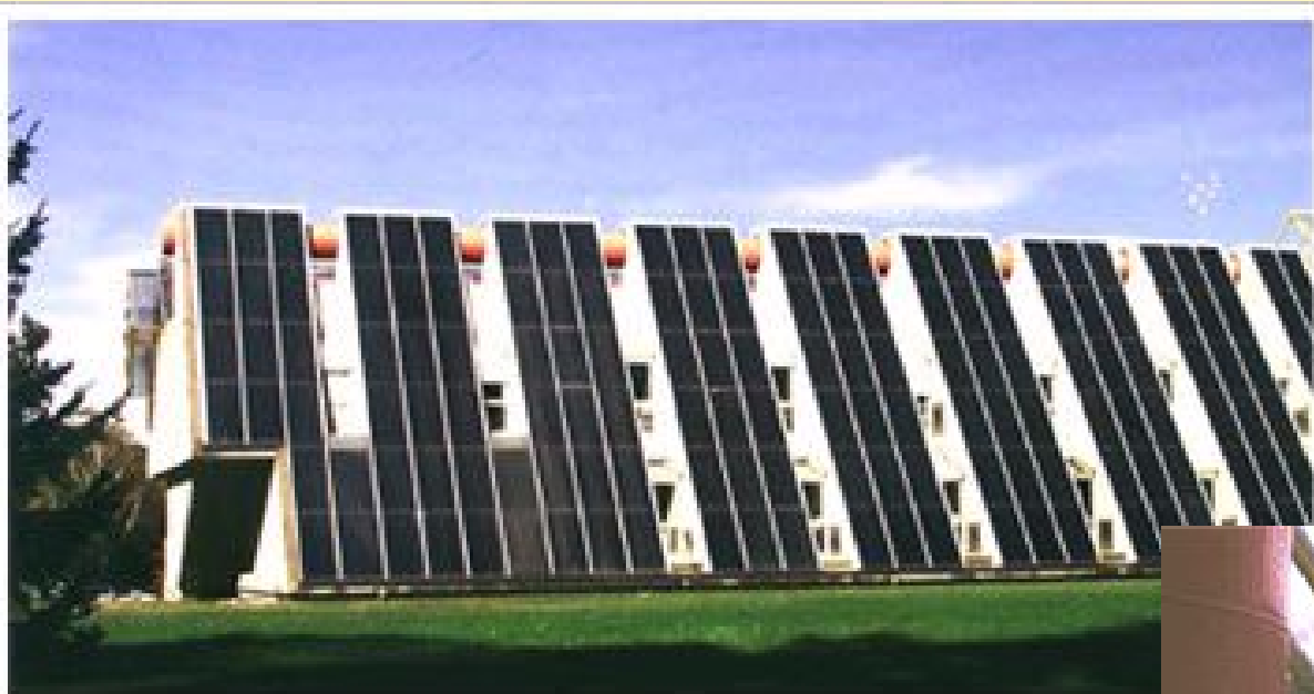
Collettori solari ad aria integrati nella parete sud del corpo A
